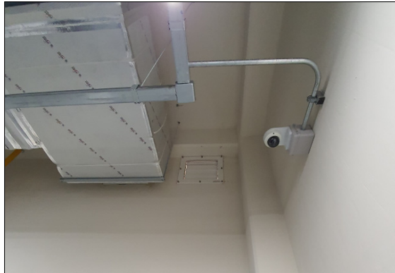
CCTV 설치 및 감시
